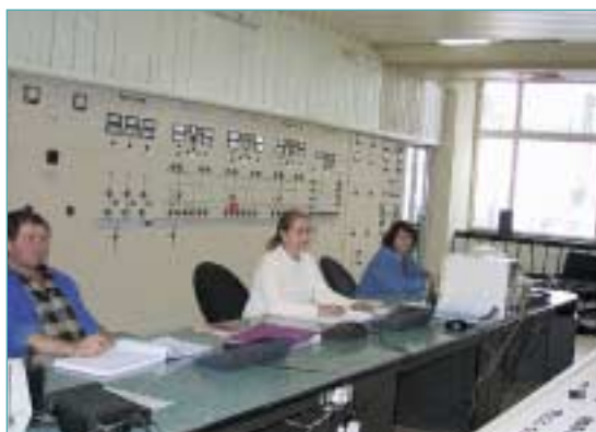
Централен щит за управление
